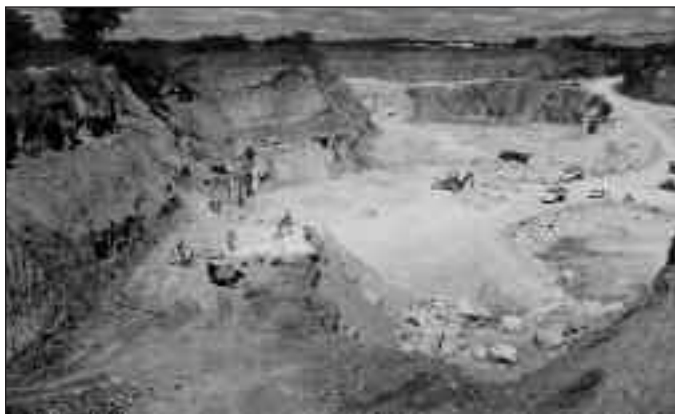
Fig. 2 - Explotación a cielo abierto en la Mineração Campo Belo del polo yesero de Pernambuco Fig. 2 - Open pit in the Mineração Campo Belo in the gypsum area of Pernambuco
